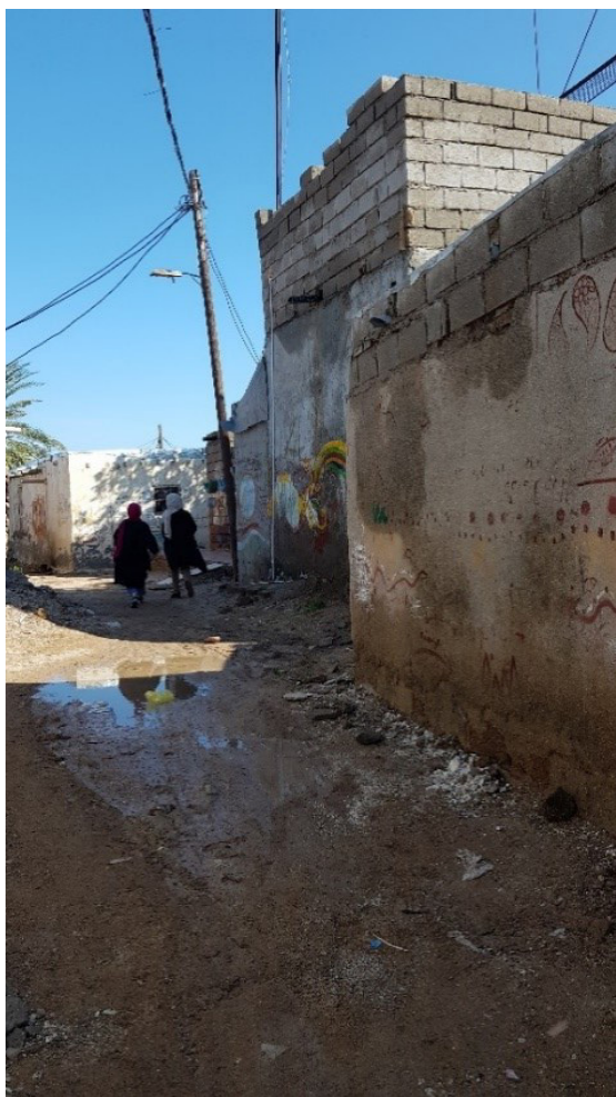
تصویر ۲. فرسودگی معابر بافت سنتی هرمز در تقابل با نوسازی معابر حاشیه جزیره. عکس: آرشیو نگارنده.
